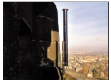
Die Antennen für die 70/23/13-cm-Baken sind in einem PVC-Rohr wasserdicht untergebracht (nach der bewährten Bauweise von Karl Weiner, DJ9HO, nachzulesen in seinen „UHF-Unterlagen“.
